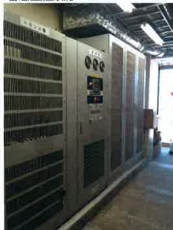
蓄電池設置状況
