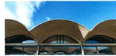
コンクリート本来打放の構構 柱の炭素繊維による補強
